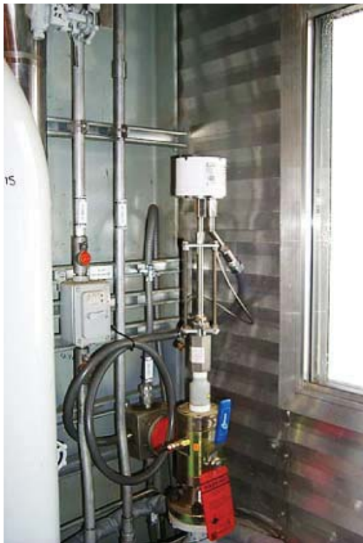
现场安装的 Microcor 变送器和可伸缩探头
